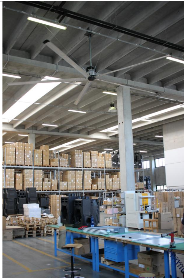
HVLS ventilátor nainstalován v továrně
