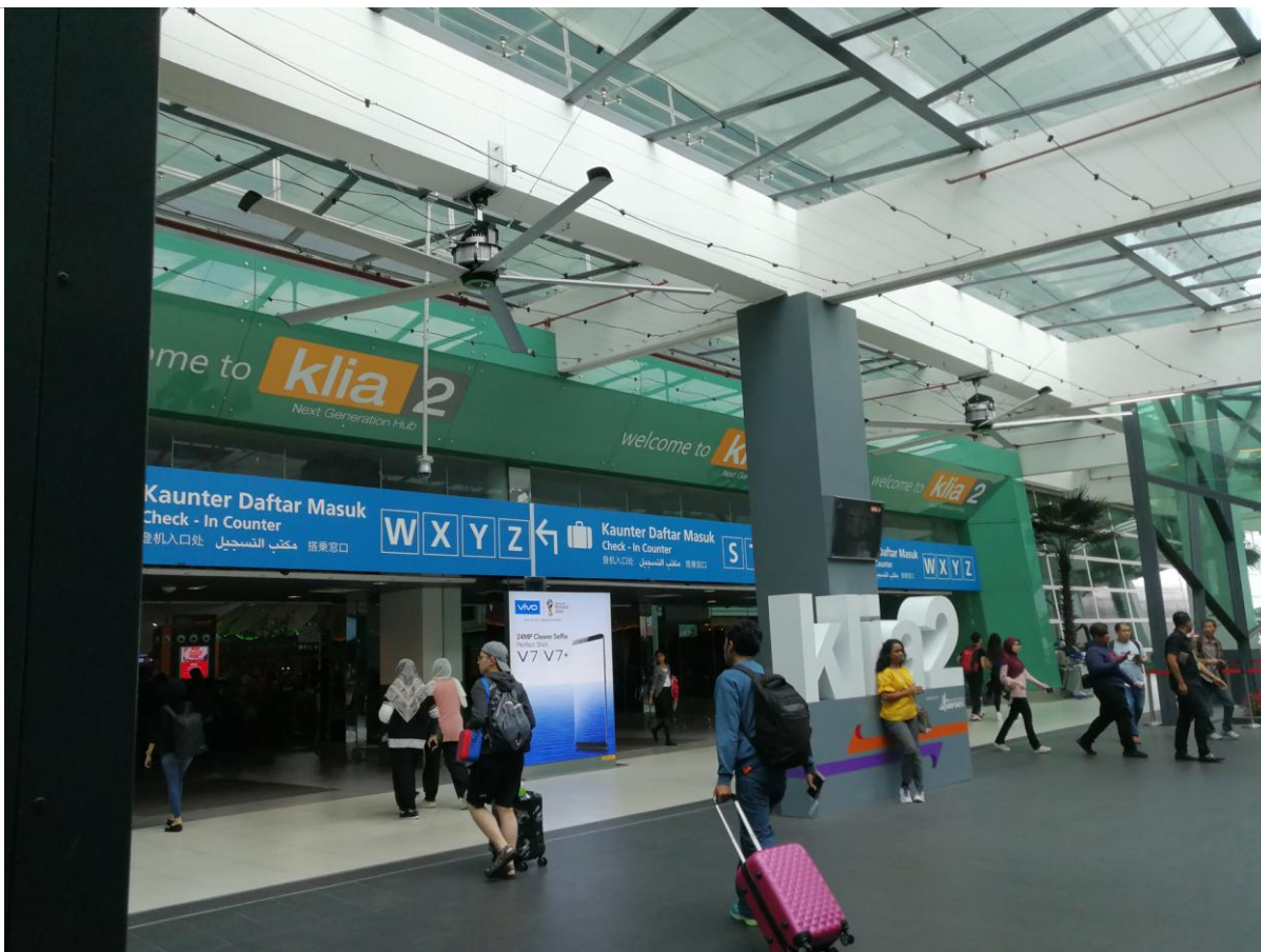
HVLS ventilátor instalován v letištní hale
