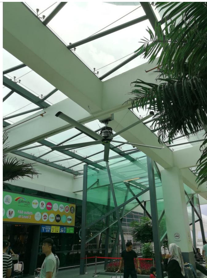
HVLS ventilátor instalován v letištní hale
