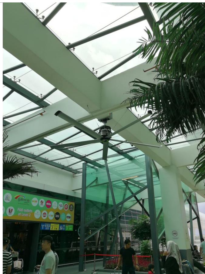
HVLS ventilátor instalován v letištní hale
