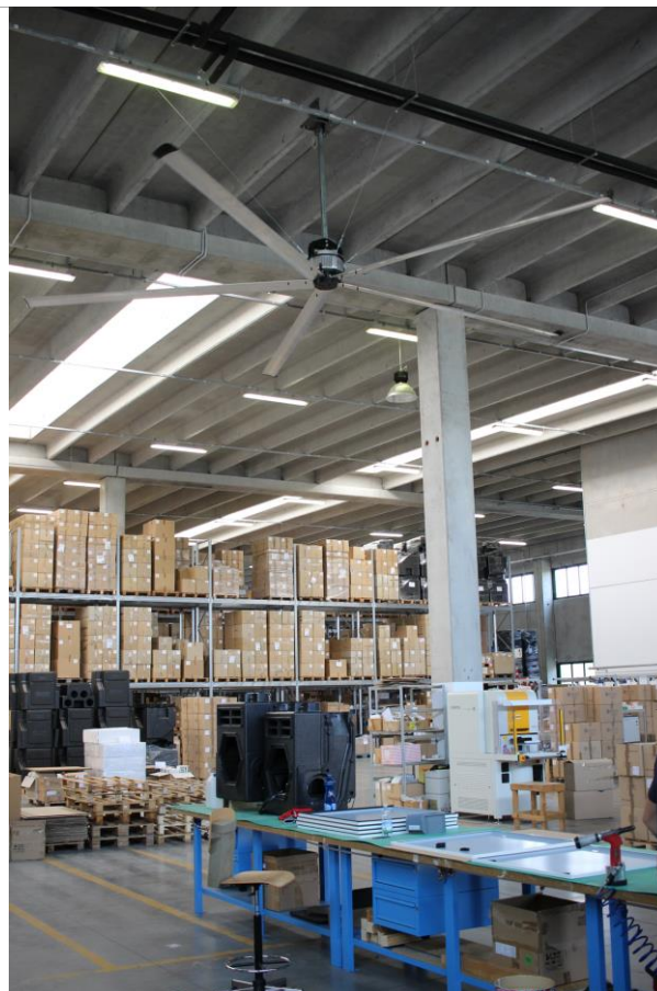
HVLS ventilátor nainstalován v továrně
