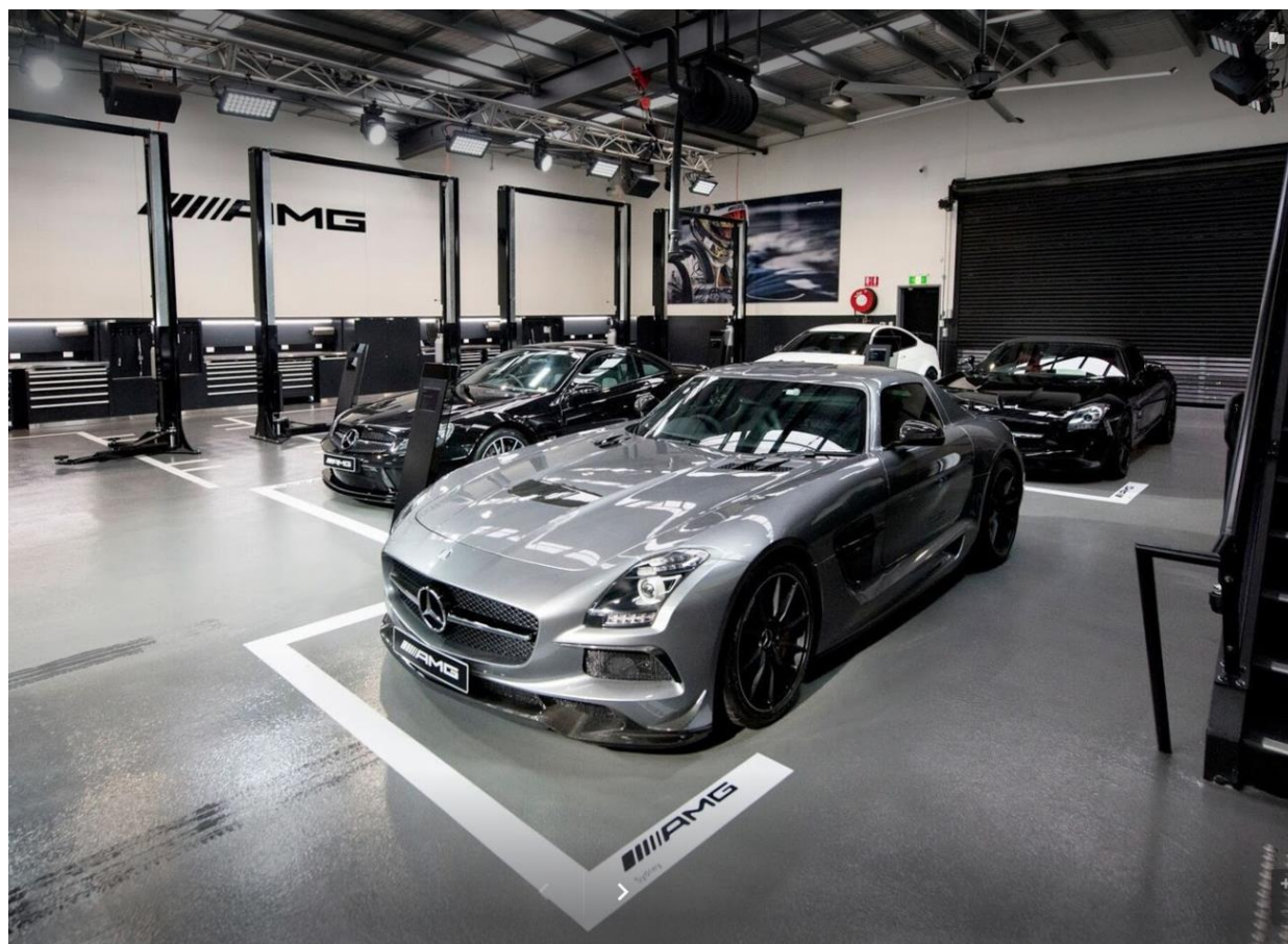
HVLS ventilátor instalován v autosalon
