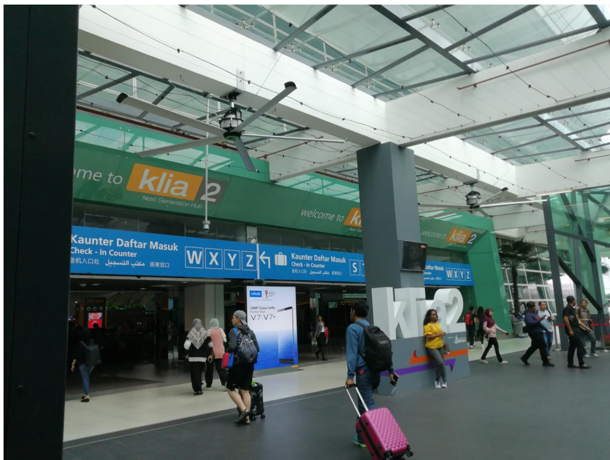
HVLS ventilátor instalován v letištní hale
