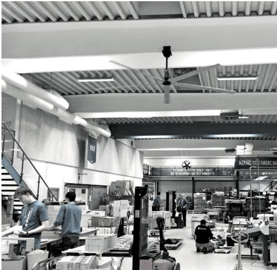
NORDIC instalace ve výrobě
