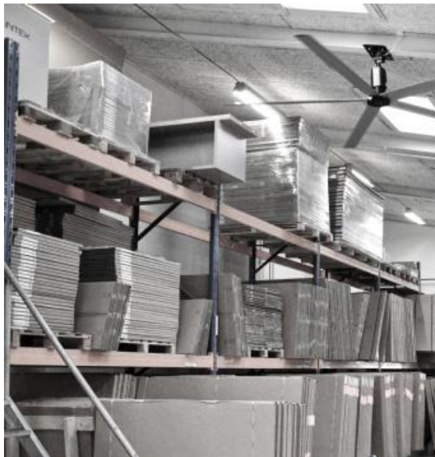
NORDIC instalace ve skladu
