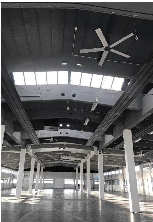
NORDIC instalace v průmyslové budově
