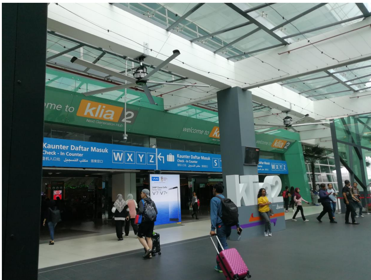
HVLS ventilátor instalován v letištní hale
