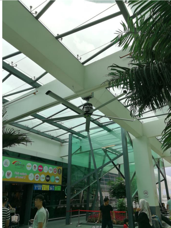
HVLS ventilátor instalován v letištní hale
